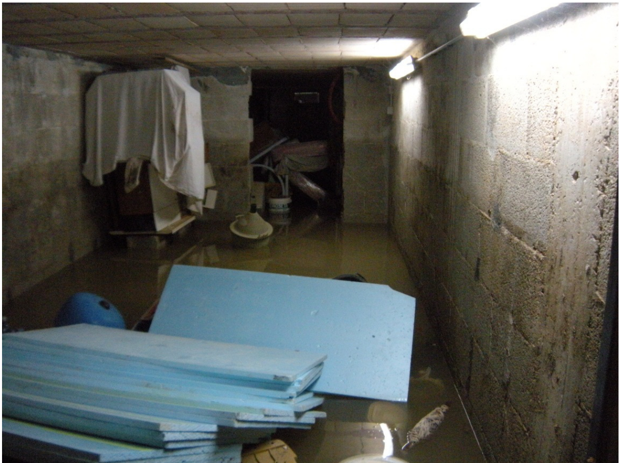
B6 – Particolare di scantinato allagato
