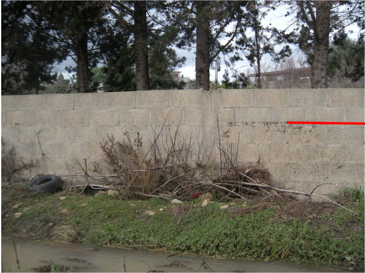
B3 – Particolare del livello raggiunto dall'acqua
