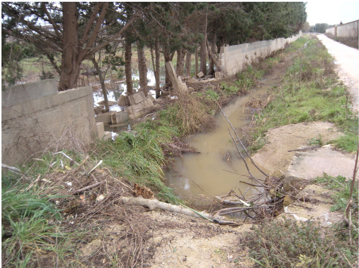
B2 – particolare del muro abbattuto
