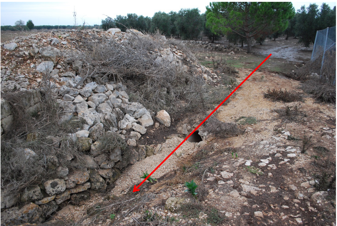
Allagamenti e canale ostruito nel percorso verso la "Vora dei Velardi Piccoli"
